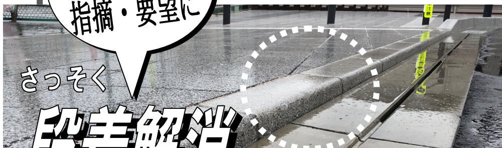
○印にあるように5センチ程度の段差が
