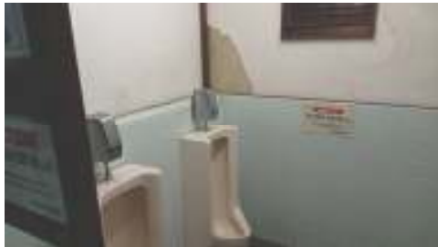
本水口の公衆トイレ。男女共用のうえ、「水が流れない」「壁がはがれたまま」の状態でした。
