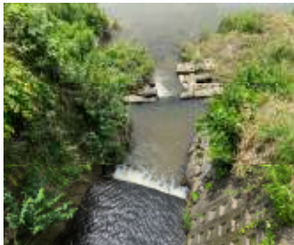
砂川と砂川の合流地点の石積みが壊れかけている
