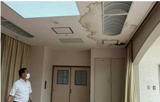
検診室の奥の天井に雨漏れシミと黒カビ
